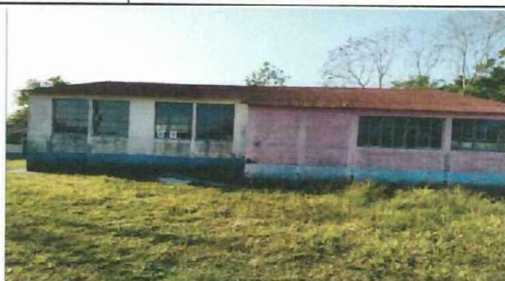
Foto 2: Vista en la parte, lado norte, donde la lámina salpica el agua en las primeras tres hileras de block y se esta desboronando por tanta humedad.
