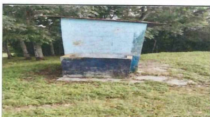
Foto 4: Este es el sanitario de tres entradas, ubicado en la parte derecha del módulo 1 por donde sale el sol. El techo esta muy deteriorado.
