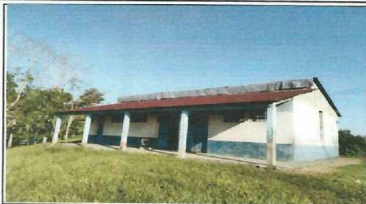
Foto 1: Este es la escuela vista de frente, desde lejos visualiza que el edificio escolar, esta muy deteriorada.
